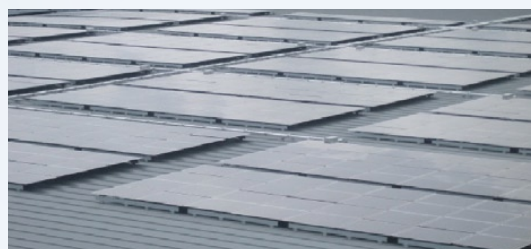
新工場に設置した薄膜型太陽電池パネル
