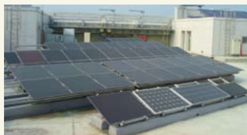
TET新社屋の屋上に設置された太陽光発電システム
