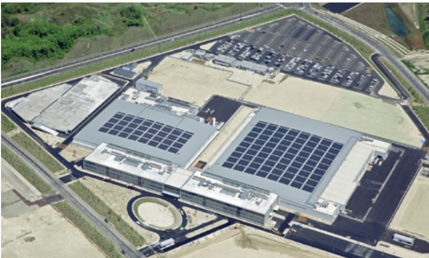
建設中のプラズマエッチング装置の新生産拠点 東京エレクトロン宮城（株）。開発と製造を一体化することで事業強化を狙う。環境対応のために屋根に太陽光発電設備を備える。
