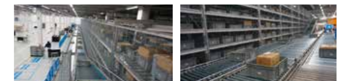
東京エレクトロン宮城 JIT 供給センター (自動倉庫)
